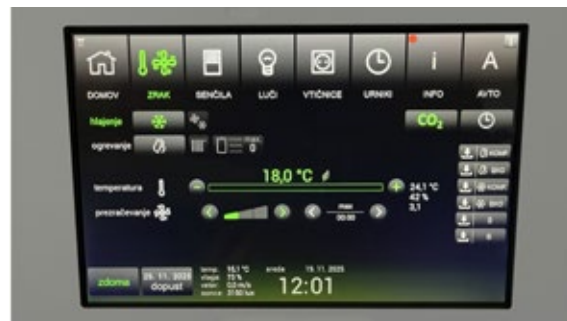
(90) Zaslon upravljalnika centralnega nadzornega sistema.
