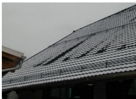
(67) Vzorec taljenja snega lahko pomaga določiti toplotne mostove v strešni konstrukciji.
