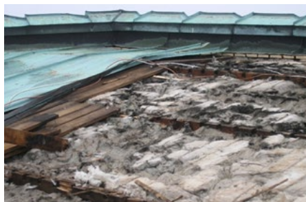
(65) Primer gradbenofizikalnih poškodb sloja toplotne zaščite v poševni strehi.
