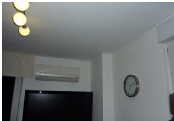
(12) V vogalu zunanjih sten in stropa (geometrijski toplotni most) je na termografskem posnetku vidna nepričakovano nizka površinska temperatura. Domnevamo lahko, da je toplotna zaščita na tem mestu oslABLJENA. Pri zunanji temperaturi –4 °C je bila izmerjena najnižja površinska temperatura 13 °C, kar opozarja na možnost nastanka površinske kondenzacije vodne pare.
